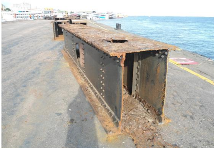
Figura 29. Viga Caixão Deteriorada
