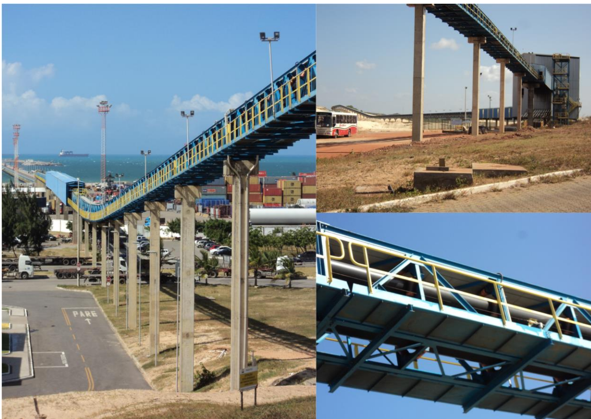
Figura 66. Correia transportadora de Carvão Mineral do Terminal Portuário do Pecém Fonte: LabTrans (2014); Elaborado por LabTrans
