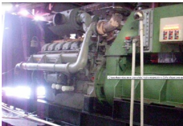
Figura 17 - Gerador utilizado no Terminal Salineiro
