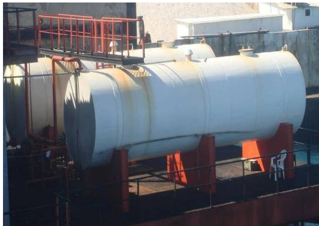
Figura 18 - Tanques de armazenamento de combustível
