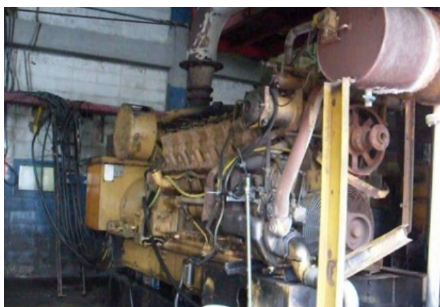
Figura 16 - Gerador utilizado no Terminal Salineiro
