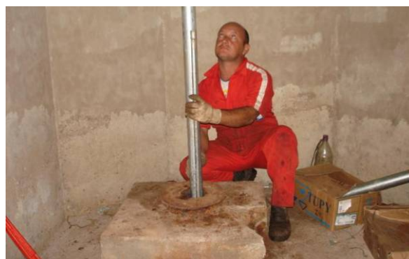
Figura 19 - Poço de abastecimento d'água
